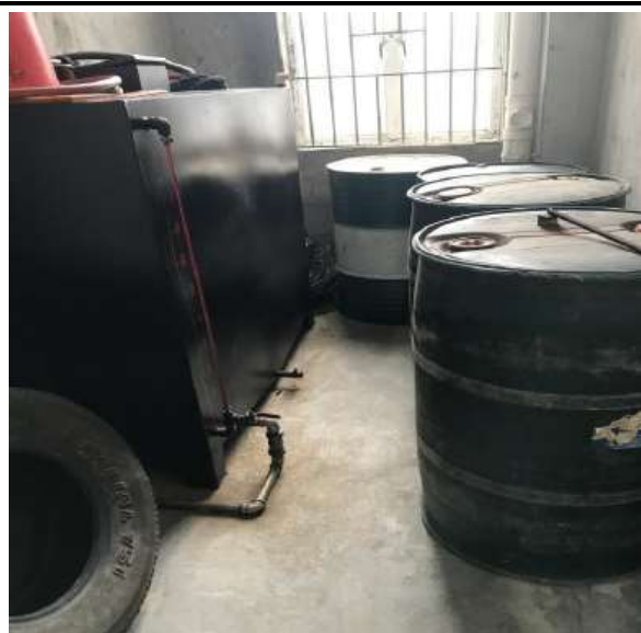
发电机房的柴油储存
