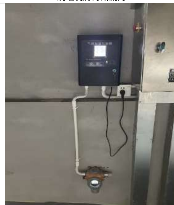
污水处理单元内的氨气、硫化氢气体警报装置
