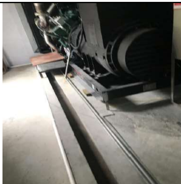
发电机房内截流沟
